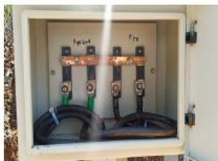
Terminasi kabel negative
